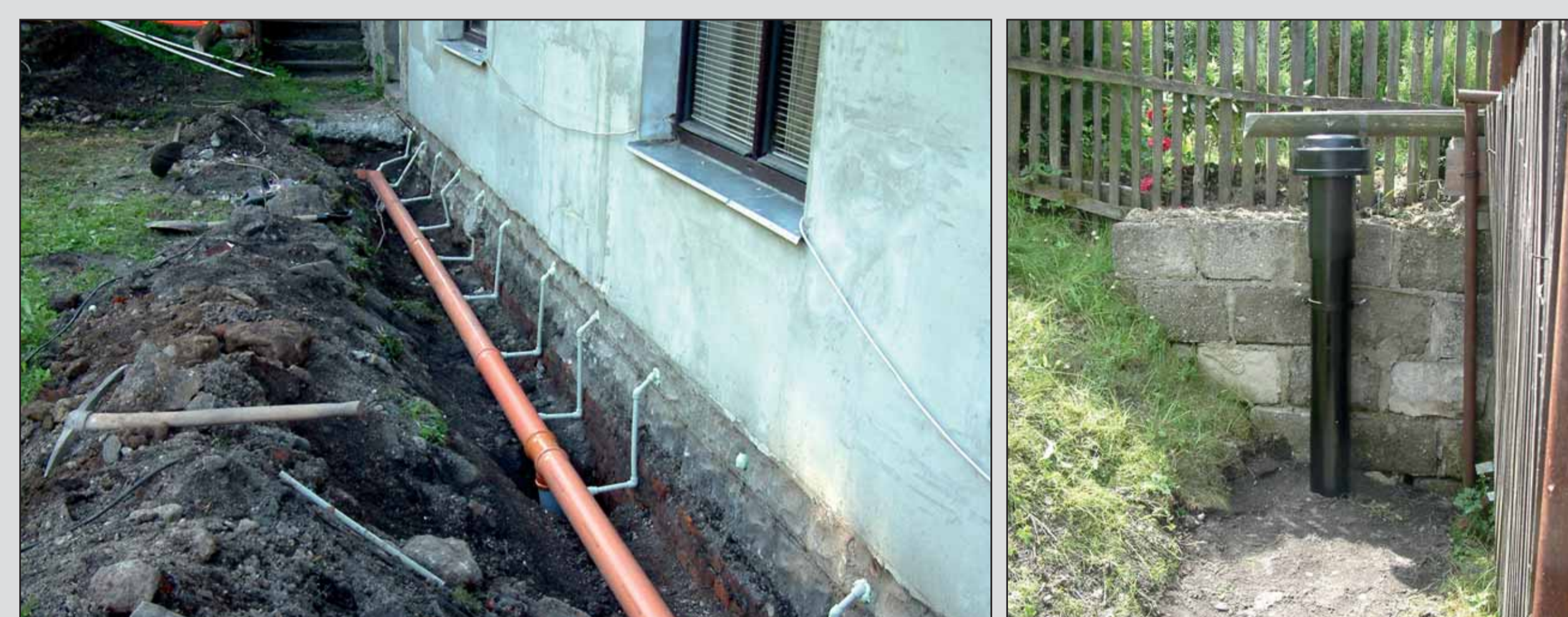
Obr. 3 – Napojení stávající vzduchové mezery v podlaze prostřednictvím sběrného potrubí uloženého pod terén k ventilátoru umístěnému vně domu.
